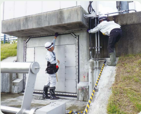
▲土器川河川管理施設監理検討業務 コンクリート損傷確認
