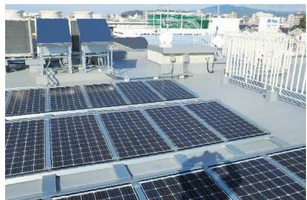
▲松山支所太陽光発電設備
