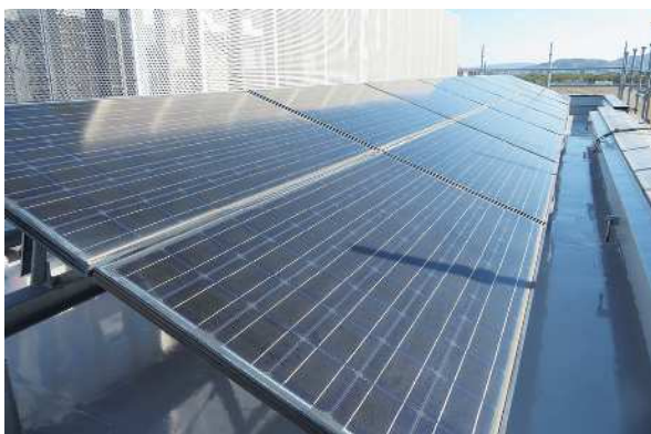
▲本所太陽光発電設備
