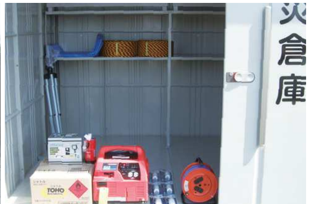
▲発電機・投光器(南国風良里)
